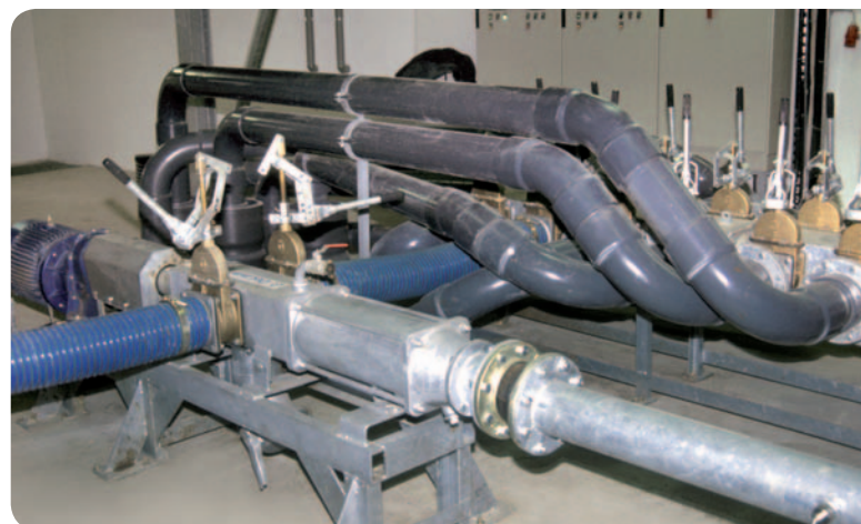
Großpumpanlage zur Beschickung einer Biogasanlage
