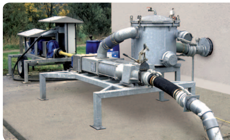
Stationäranlage mit Elektromotor und Steinfangtopf
